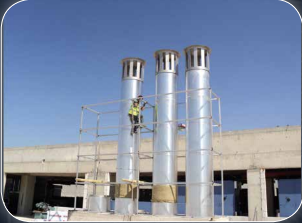
Çift Cidarlı Paslanmaz Çelik Doğalgaz Bacası - Malatya 600 Yataklı Devlet Hastanesi - Malatya
