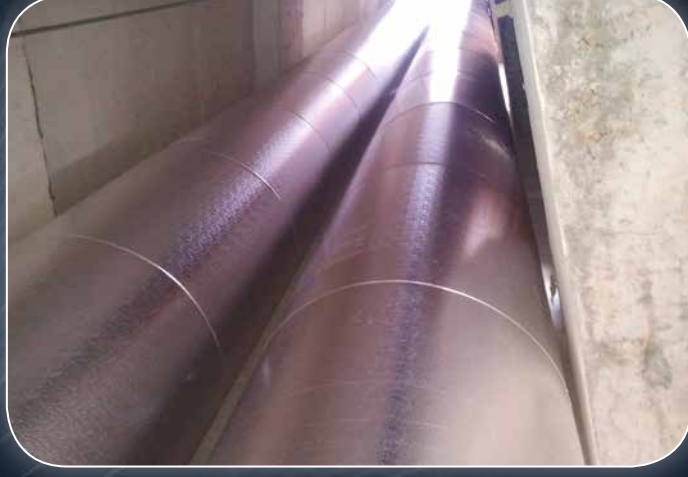
Şaft İçi Paslanmaz Çelik Çift Cidarlı Baca Uygulaması
